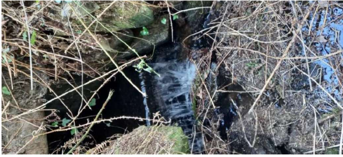
Photo 120- Discontinuité en aval de la route communale (source : Fédération de pêche 56)
