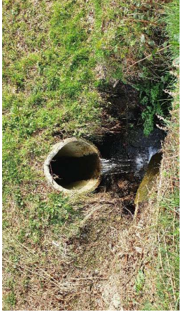
Photo 106- Rupture de discontinuité amont
