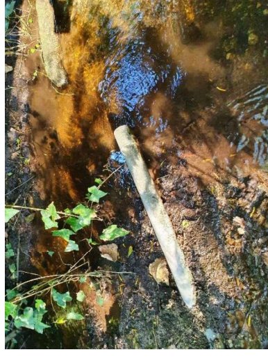
Photo 126- Exutoire du drain (tuyau PVC) directement dans le cours d'eau
