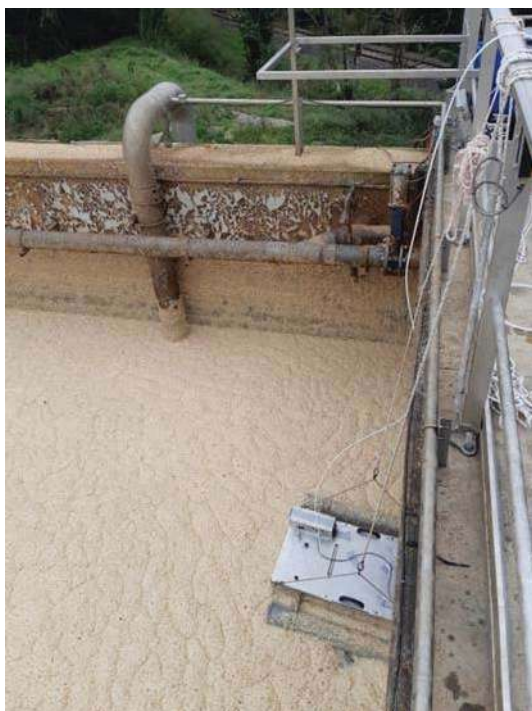
Photo 11 : Bassin R3F (aération)
