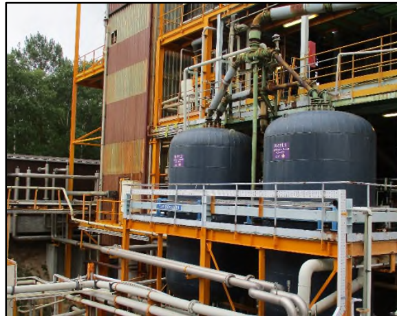
Figure 13. Cuves d'hydrolyse BCF1
