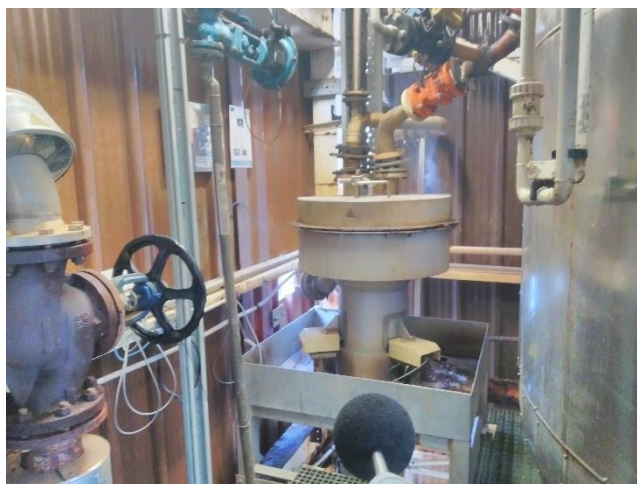
(*) l'équipement qui augmente le niveau de bruit au 2 -ème étage
