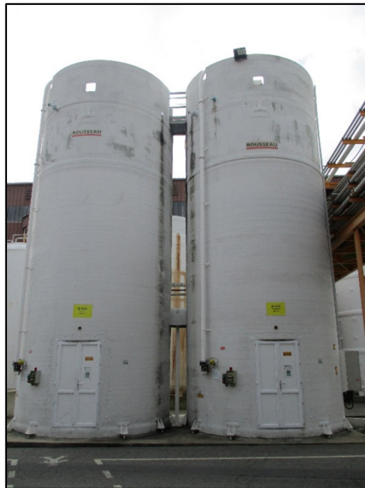
Figure 46. Silos de stockage du charbon actif existants
