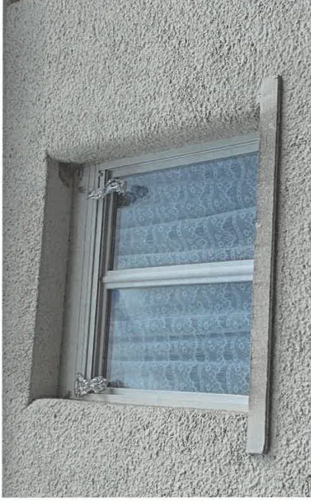
Dispositif anti-hironnelles sur au moins 6 fenêtres au niveau de la place principale de Trédion
