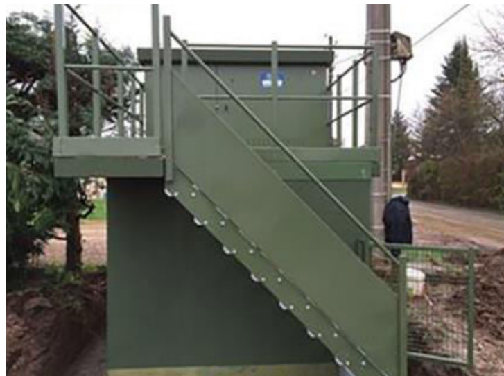
Figure 30: Exemple de postes de transformation et de livraison HTA/BT (Groupe Cahors, s.d.)
