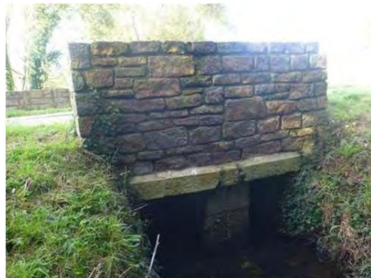
Photo 10. Ponceau en maçonnerie (deux ouvertures de 0,65 m x 1,00 m) sur le Saut du Renard côté amont de la RD162, lieu-dit la Vieille Saudraye
