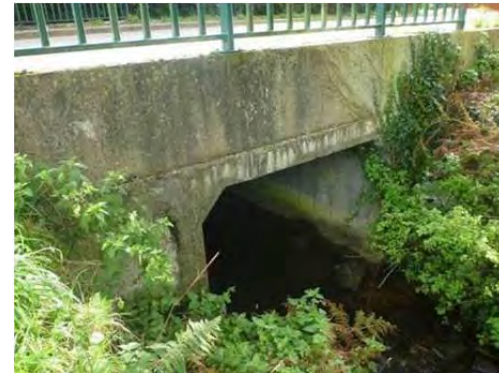
Photo 9. Cadre béton 2,00 x 1,50 m sous la VC2 au pont de Kerrouarch (ruisseau le Saut du Renard)
