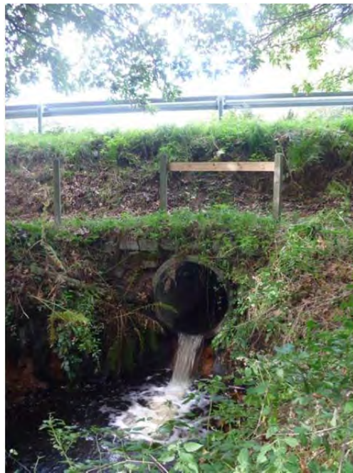
Photo 22. Buse trop petite pour permettre le passage d'une loutre par exemple (passage au lieu-dit Saint-Fiacre)
