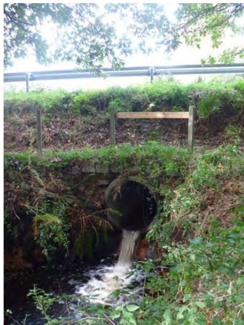
Photo 76. Buse trop petite pour permettre le passage d'une loutre par exemple (passage au lieu-dit Saint-Fiacre)
