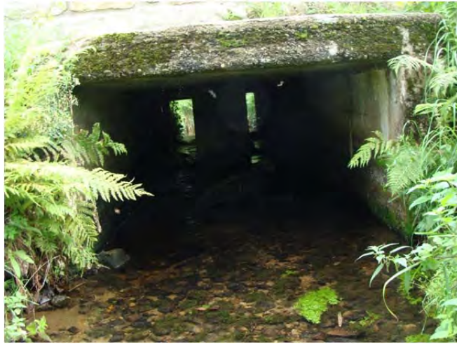
Photo 70. Ouvrage sous la RD162 (vue amont). Faible tirant d'air limitant fortement les continuités écologiques
