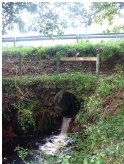
Photo 3. Buse trop petite pour permettre le passage d'une loutre par exemple
