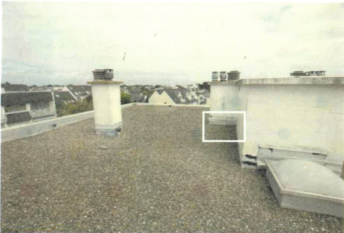
Figure 1 Nid de Goéland argenté à l'abri des vents dominants sur un toit d'immeuble.
