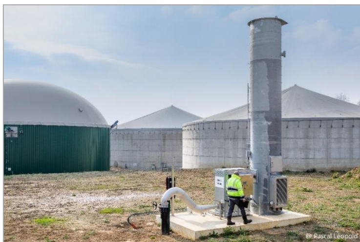
Photographie 17 : Exemple de torchère de sécurité (Source : ENGIE BiOZ)
