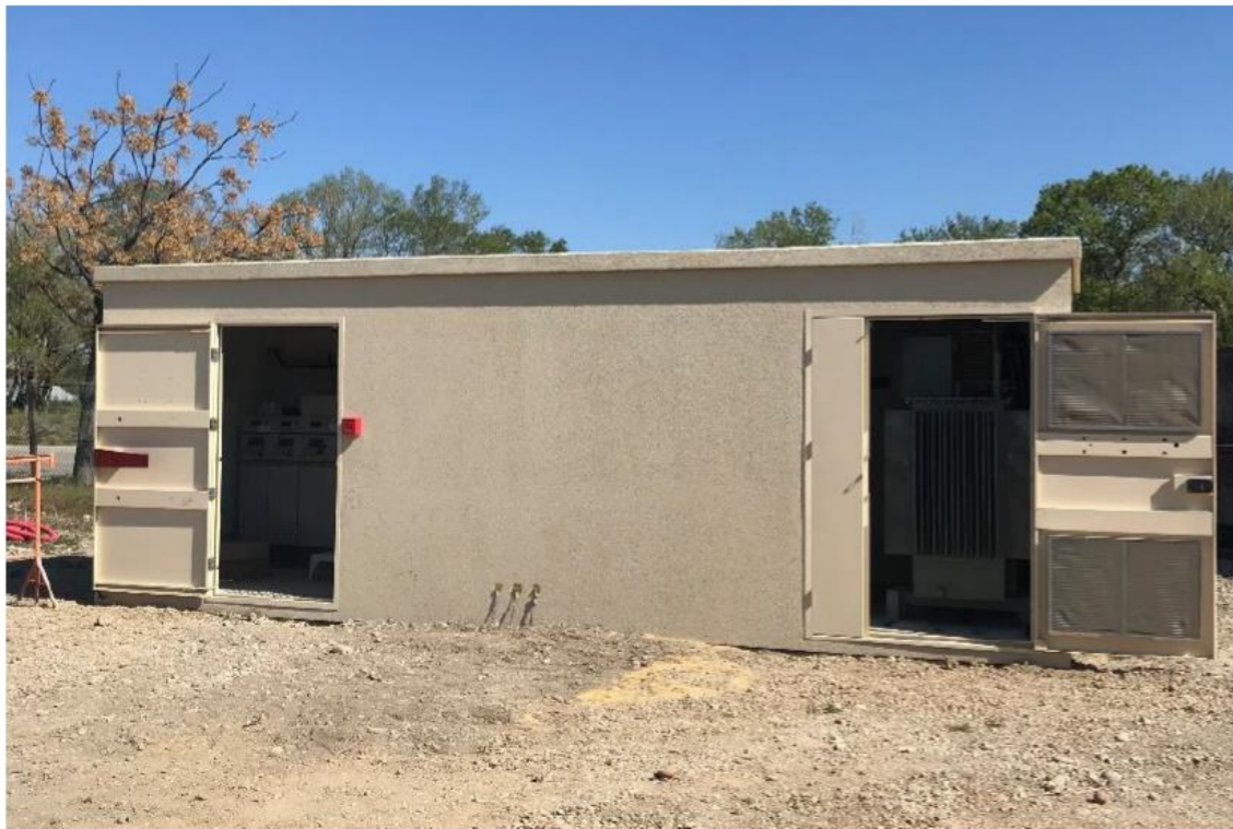
Figure 5 : Photographie d'un poste de livraison/transformation
