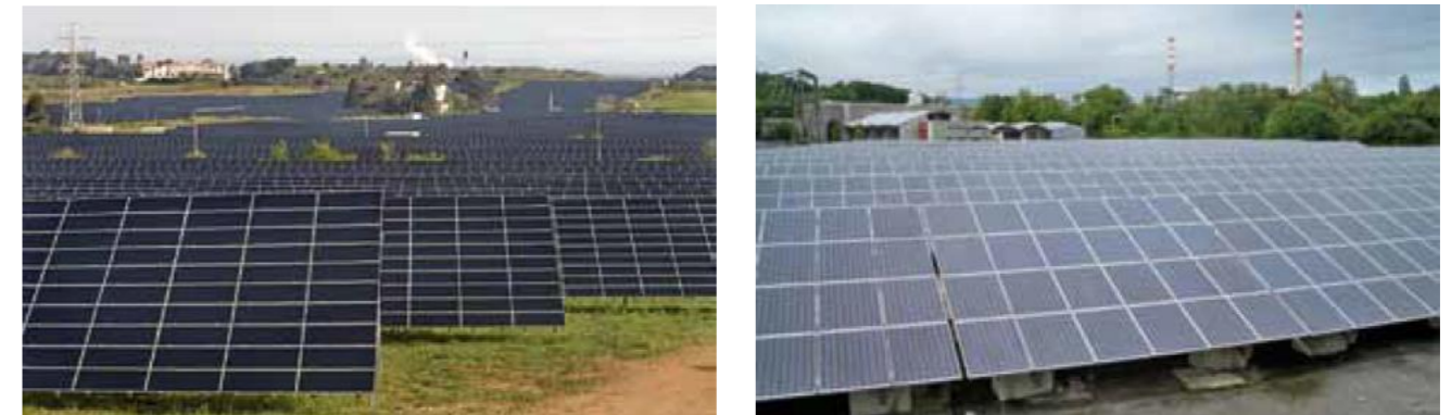
Photo 1 : Installations fixes au sol.
