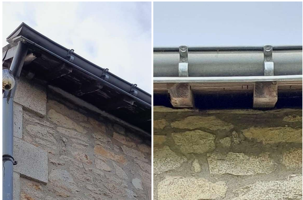
Avancée de toiture du local associatif, à noter la présence d'espaces vides entre la toiture et la façade (© Biotope, 2023)
